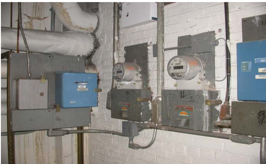
Con Edison kWh Pulse Demarcation and Totalizer
